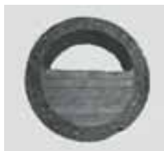
Verkalkte Wasserleitung nach 10 Jahren ohne Reinigung.
